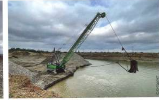
Les deux treuils ont chacun une capacité de 275 kN.
